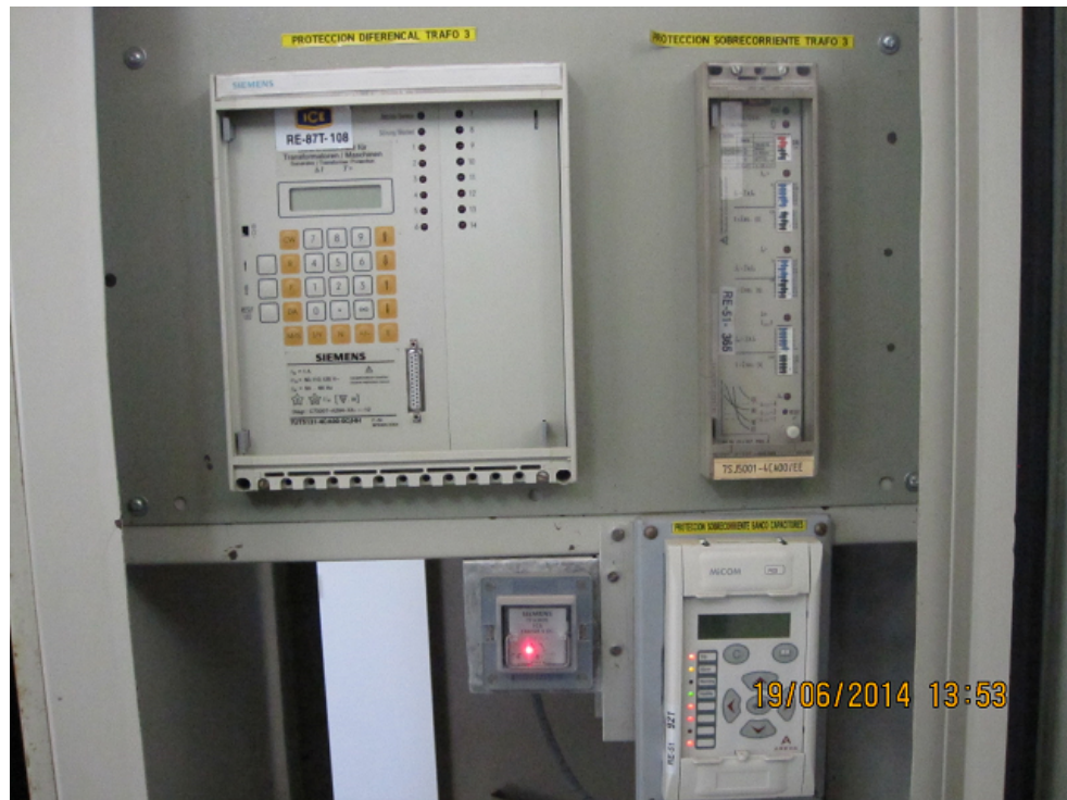
Figura B.4: Protecciones del primario de los transformadores principales ajustadas por el ICE, ubicadas en la subestación.
