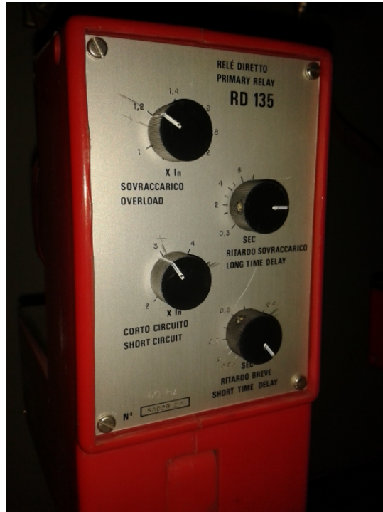
Figura 2.31: Vista frontal del relé de máxima corriente FIR RD-135. (foto tomada en la empresa)
