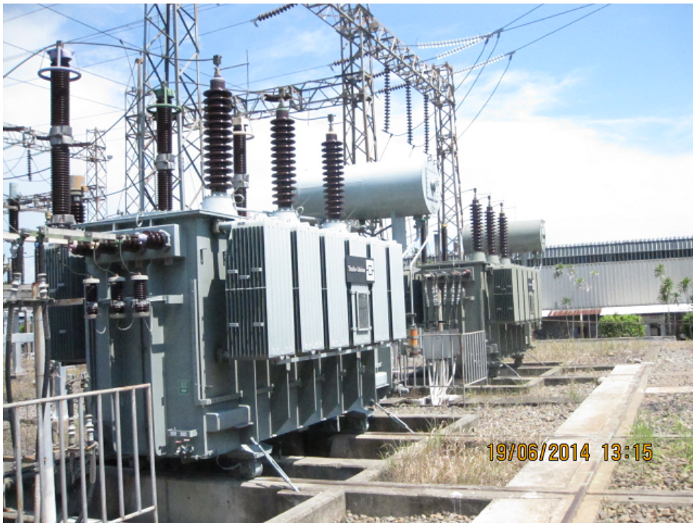
Figura B.3: Transformadores principales que alimentan ALUNASA, ubicados en la subestación Juanilama.
