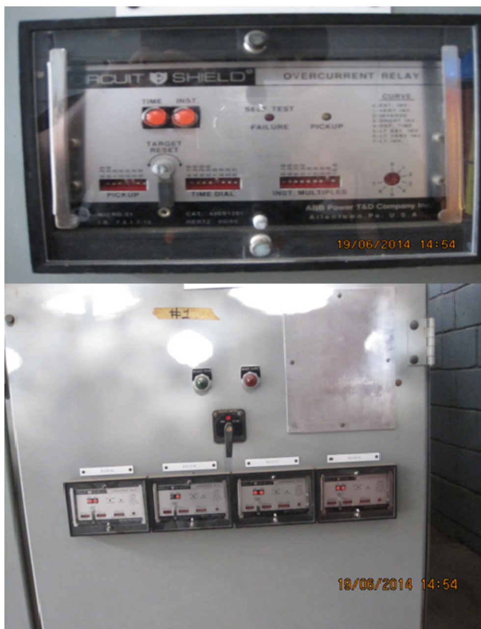
Figura B.6: Relés de sobrecorriente ABB micro-shield, en el secundario del transformador principal.
